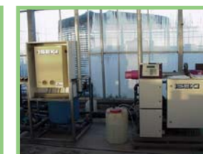
環境保全とコスト削減を可能にする排水再利用設備
