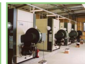
温室内の温度むらをなくす温湯暖房設備
