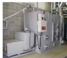
バイオマスボイラ
