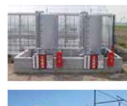
ボイラの燃料を貯留します。
