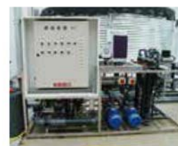
養液供給装置
